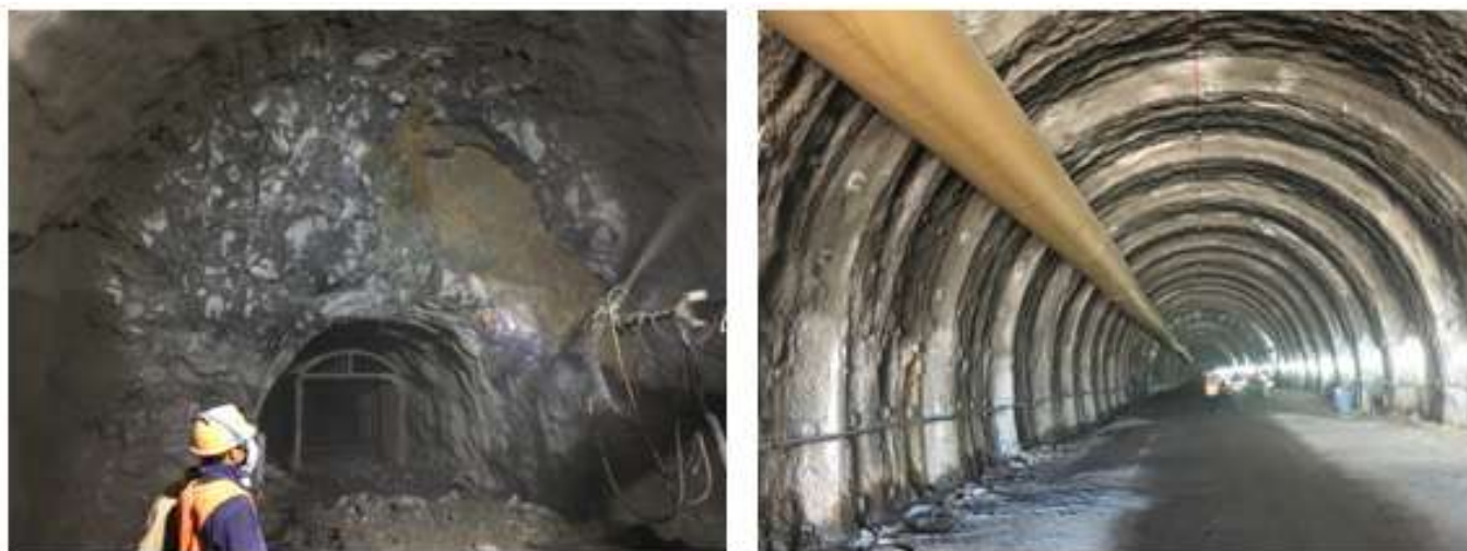
Рисунок 15. Разрушение крепи существующего тоннеля после взрыва во вспомогательном тоннеле. Figure 15. Destruction of the poling boards of the existing tunnel after the explosion in the auxiliary tunnel.
